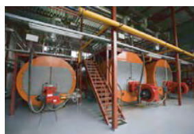
ボイラー廃熱
